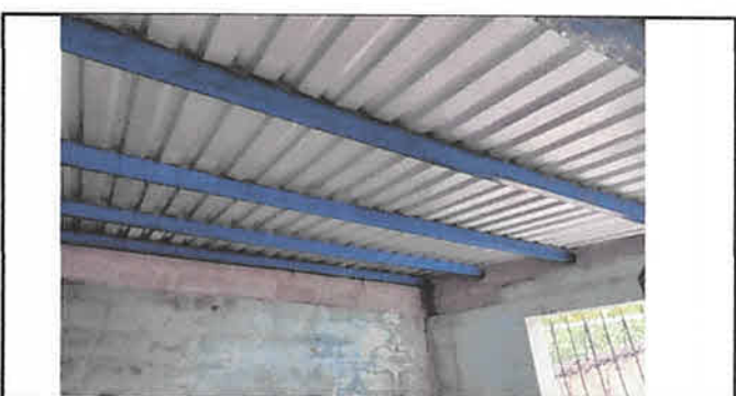
FOTO 6: LEVANTADO DE PARED EN COCINA Y COLOCACIÓN DE ESTRUCTURA DE METAL E INSTALACIÓN DE LÁMINA TROQUELADA
