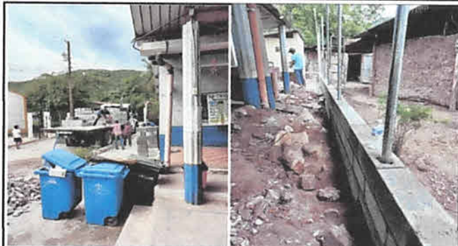
FOTO 2. DESCARGA Y ACOPIO DE MATERIAL E INICIO DE LEVANTADO DE MURO DE BLOCK
